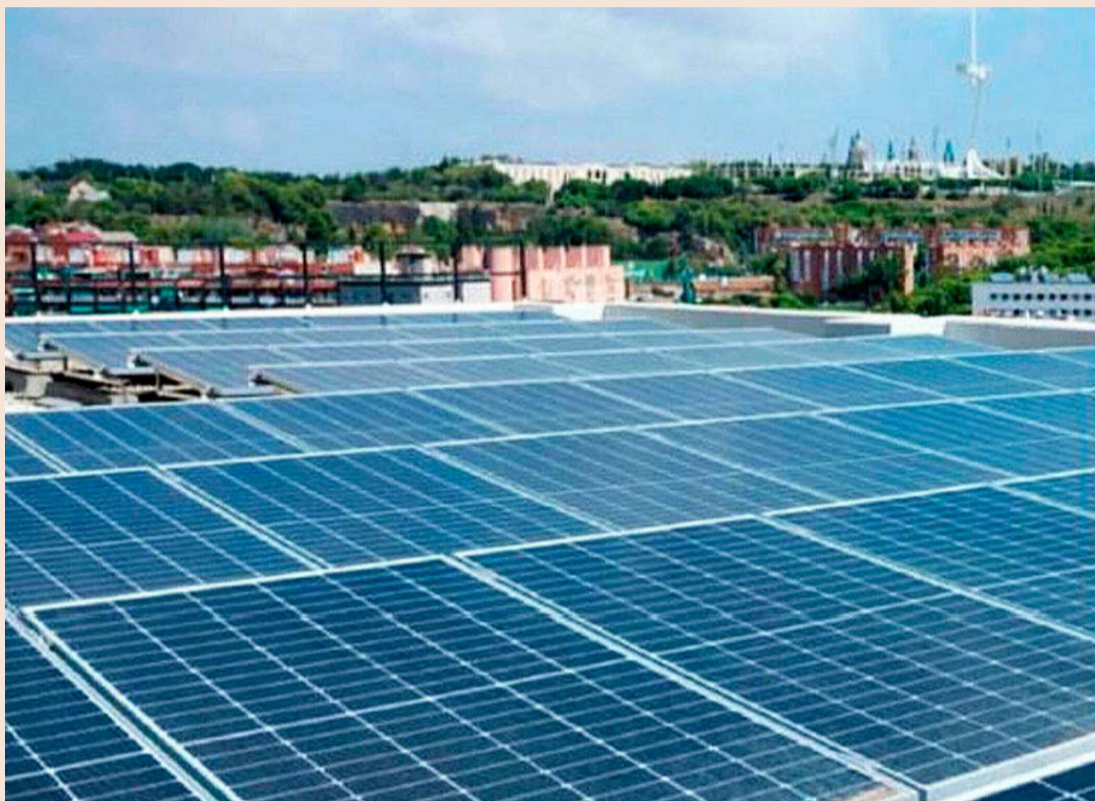
Placas solares instaladas en la sede central de Wallbox en la calle del Foc de Barcelona.
